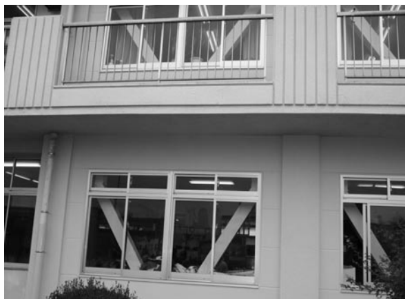
ブレースで補強された校舎(東中)
